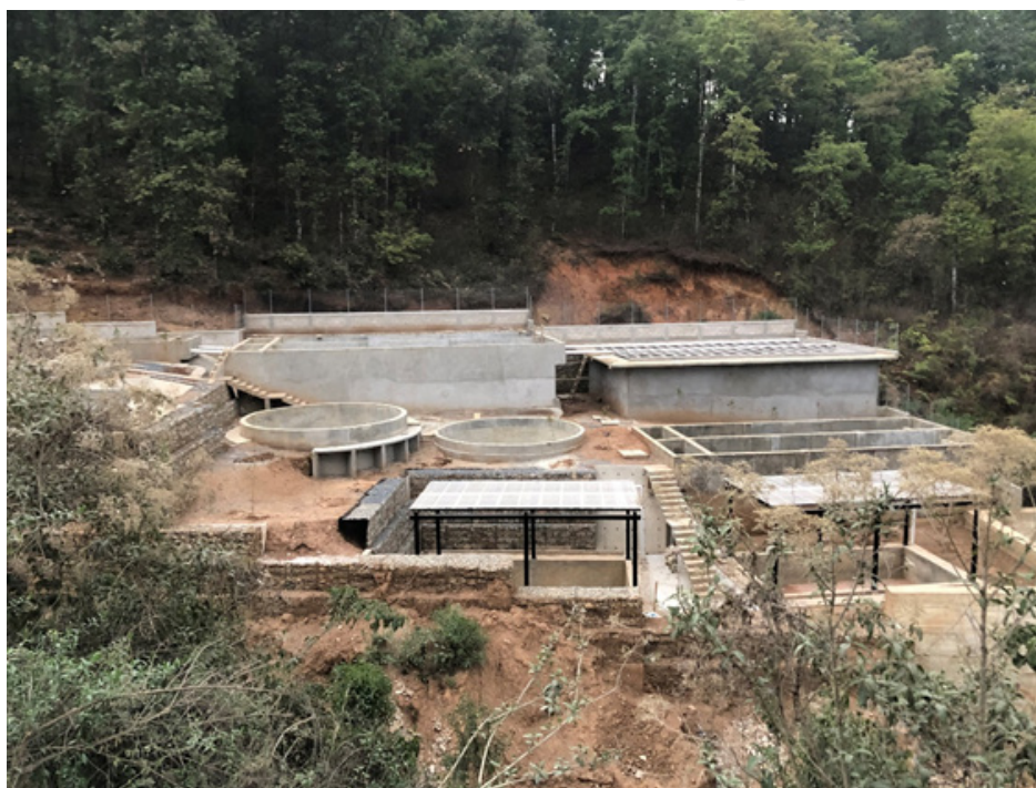
Planta de tratamiento no terminada de la aldea Tzalbal.
