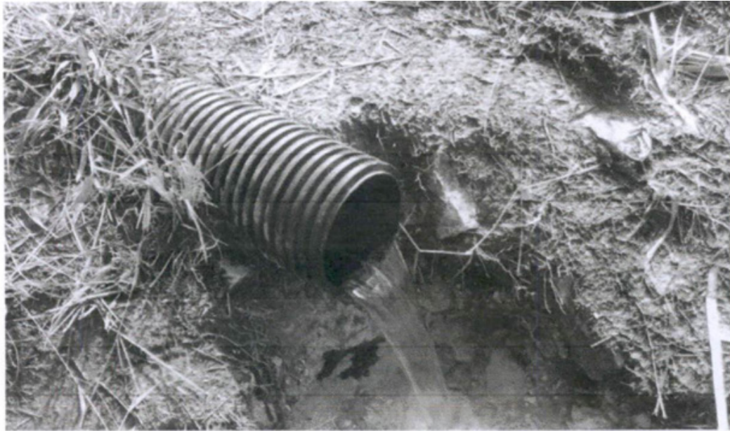
4: La filtración en el talud de la Represa Principal es confirmada al sistema de drenaje subterráneo, flujo estimado de 2 a 3 L/s
