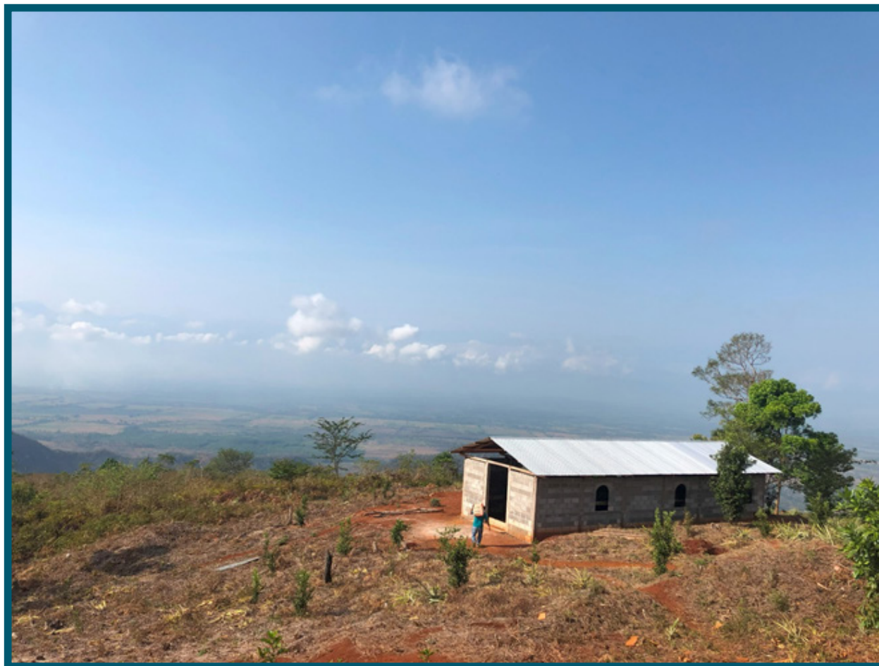
Construcción del salón comunal Agua Caliente Lote 9, El Estor. Foto: GHRC, tomada el 19 de abril de 2024.
