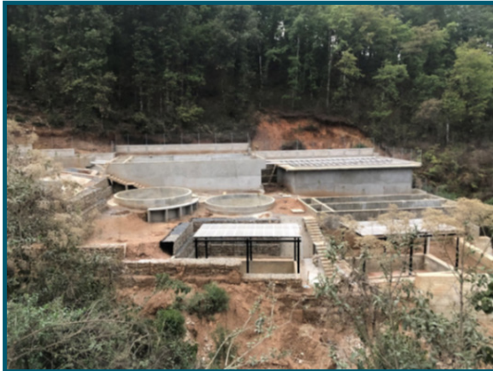
Planta de tratamiento no terminada de la aldea Tzalbal. Foto: El Observador, 26/04/2023.
