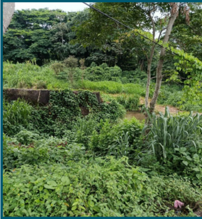
Estado de una sección de la infraestructura asociada con los gaviones en el Río Sis.
